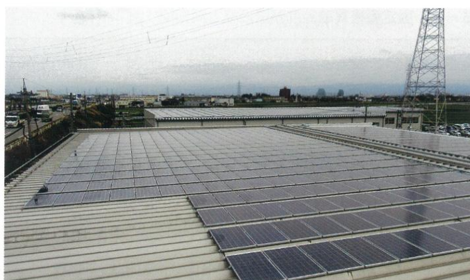
工場屋根のソーラーパネル
