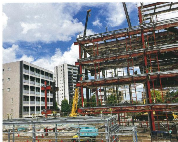
北陸電気保安協会技センター・本店ビル (提供：日本海建興)
